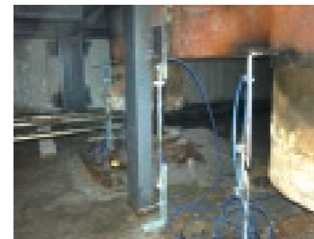
结构位移监测
